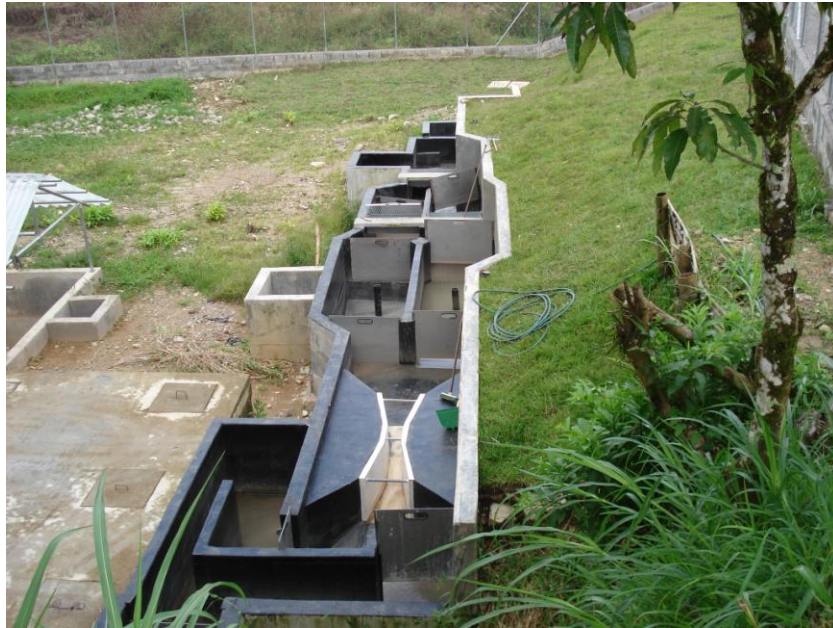
Foto 4. Canal de entrada a la planta de tratamiento de aguas residuales sector sur
