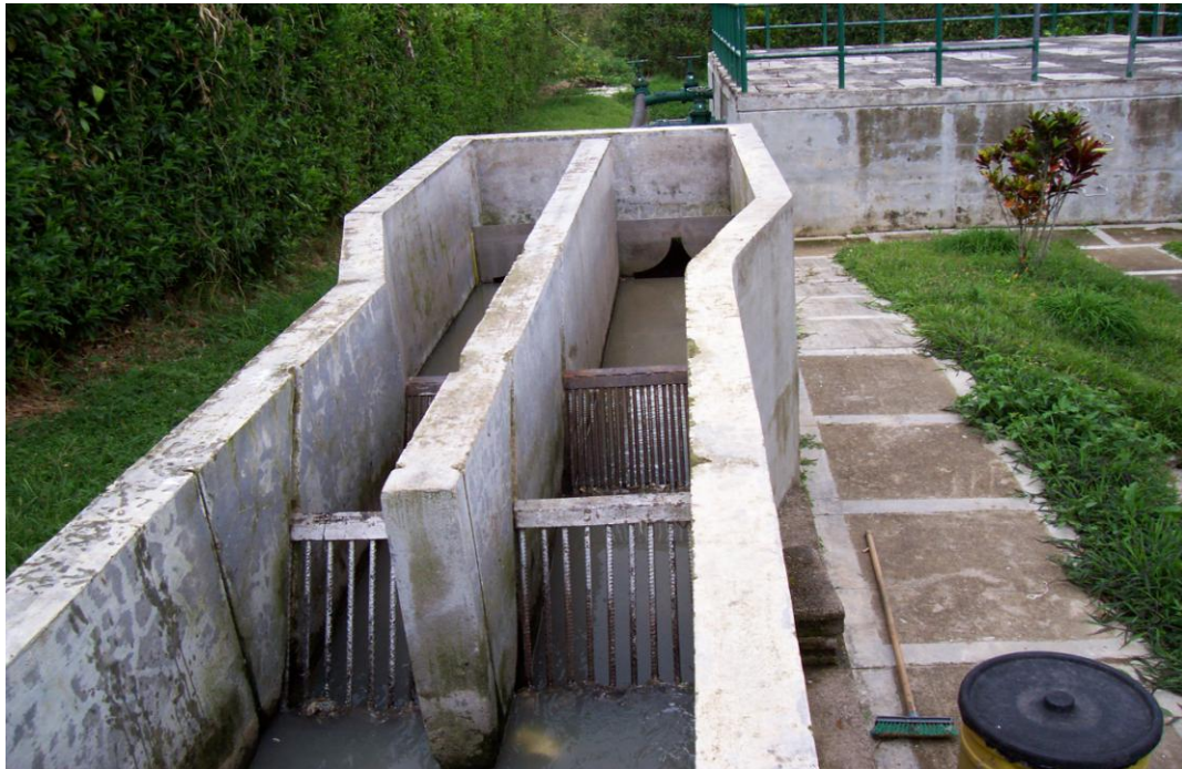
Foto 1. Canal de entrada a la planta de tratamiento de aguas residuales.
