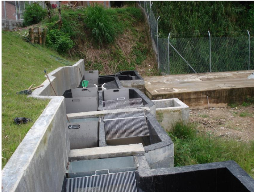
Foto 3. Cribado Canal de entrada a la planta de tratamiento de aguas residuales sector sur.
