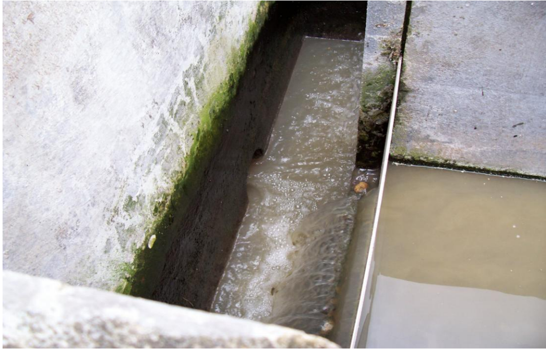
Foto 2. Vertedero e ingreso del agua residual al IMHOFF
