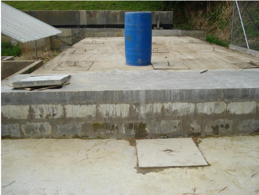
Foto 5. Tanque IMHOFF. PTAR sector sur
