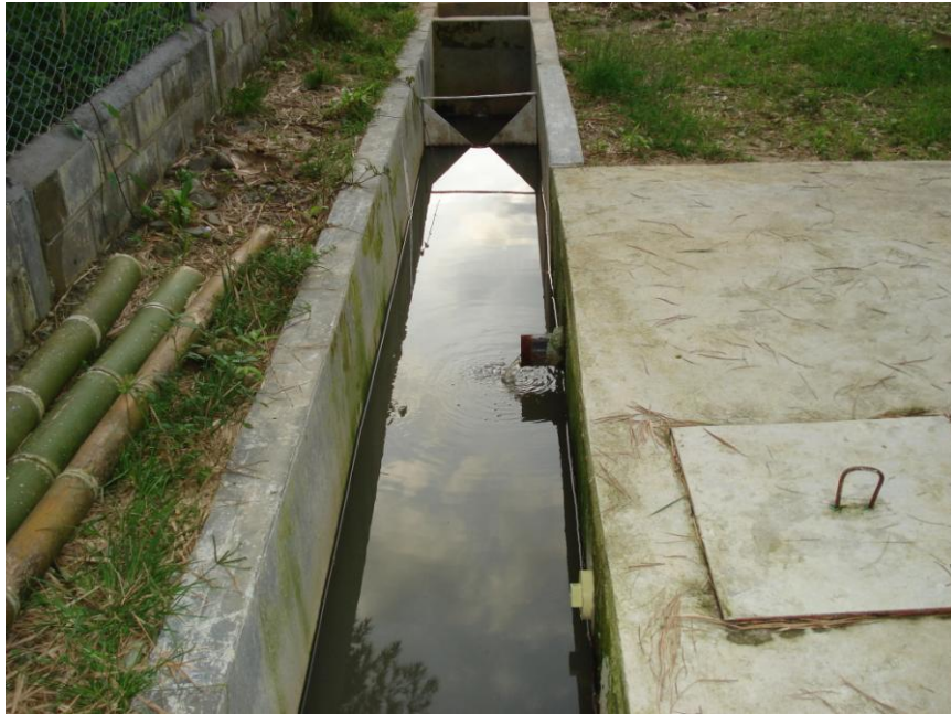
Foto 6. Vertedero salida tanque FAFA
